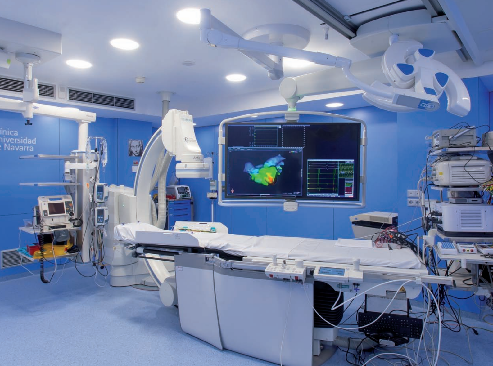
Las dos salas cuentan con sistemas de imagen, de rayos X y de escopia, junto a los tres principales sistemas de navegación.
